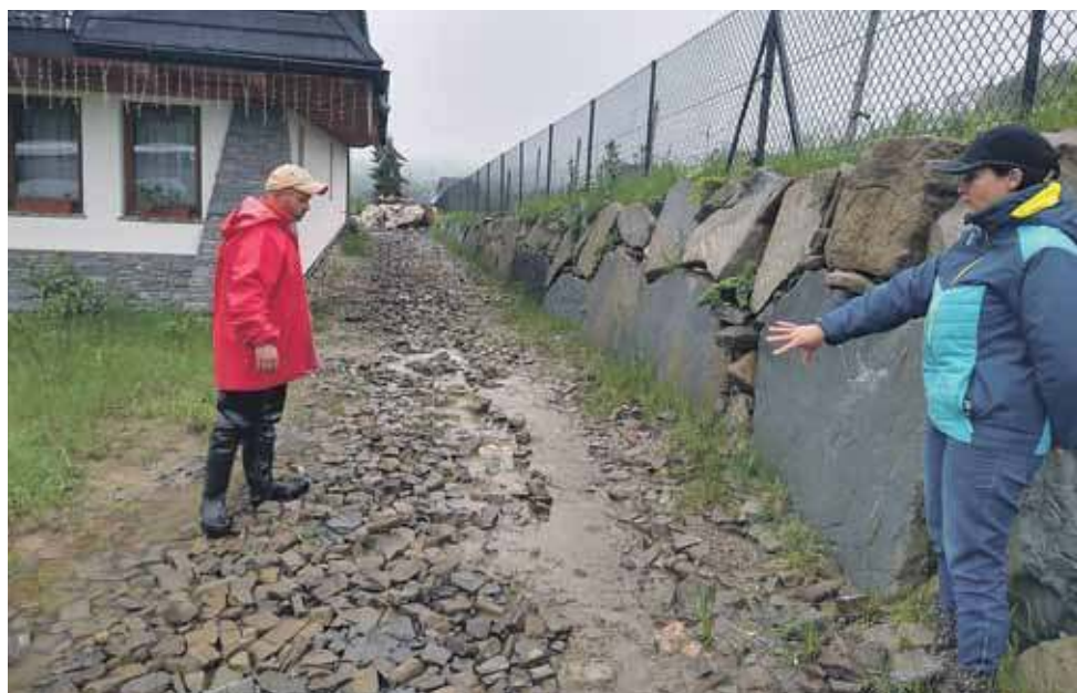
Woda, która przeszła obok domu, naniósł muł i wdarła się do kotłowni.
