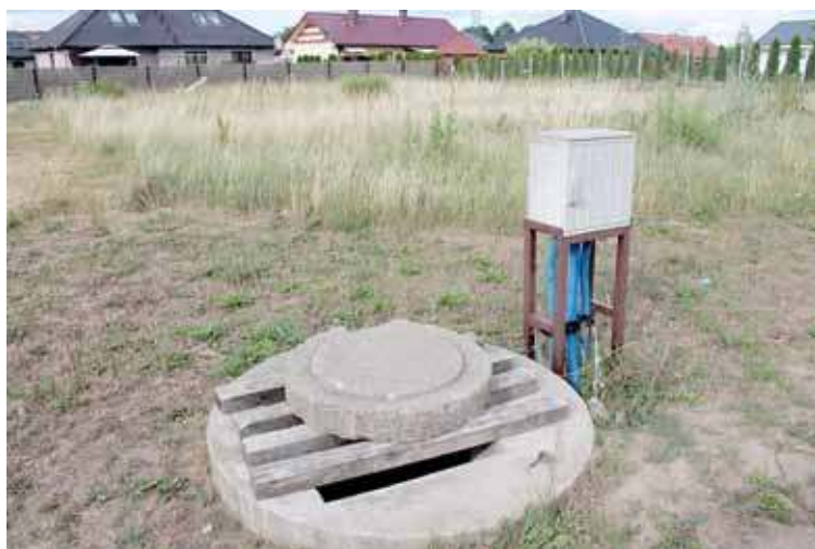
Studnia z przepompownią, która jest obecnie wyłączona
