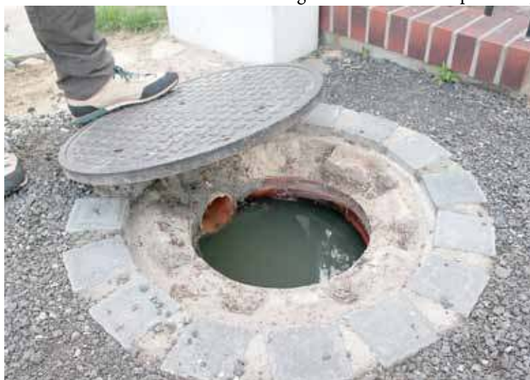
Studzienka, a w niej odpływ, którym ścieki płyną dalej w pole inaczej zalałyby pobliską posesję
