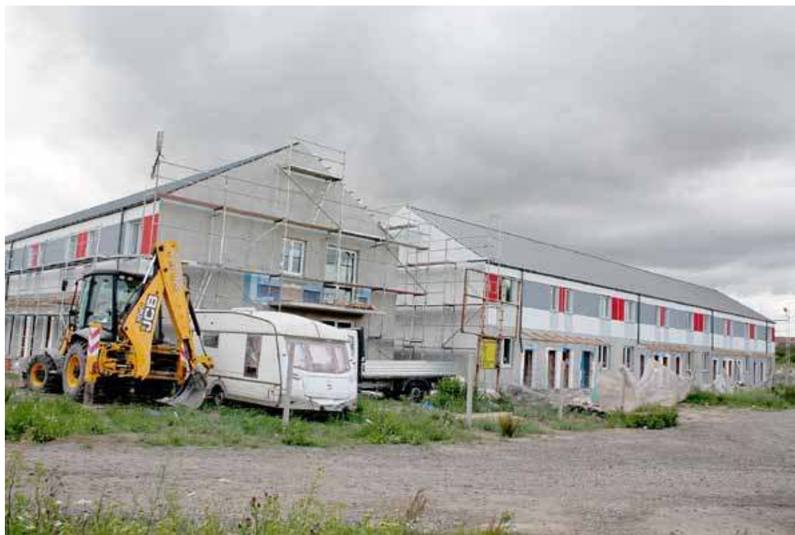
Nowopowstające obiekty mieszkalne również mają być podłączone do sieci wod. kan., która jest wadliwa
