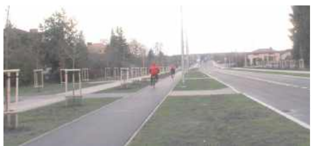
Ścieżka rowerowa szeroka na 2 m na Al. Riada Haidara nagle zaczęła w niektórych miejscach pękać i się załamywać
