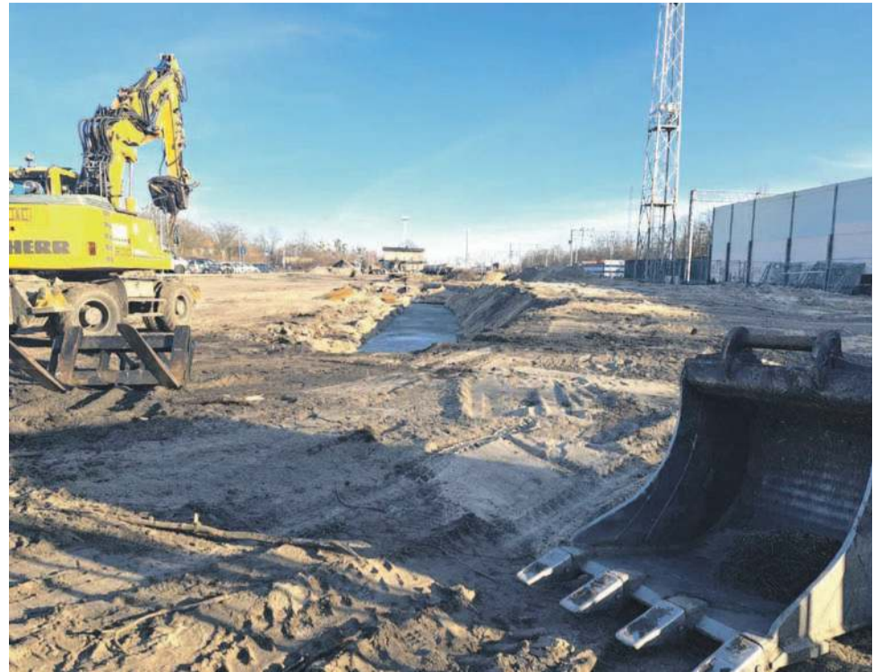
Planowana jest m.in. wymiana i przebudowa istniejących torów, a także rampy do załadunku i rozładunku towarów, w tym... czolgów
