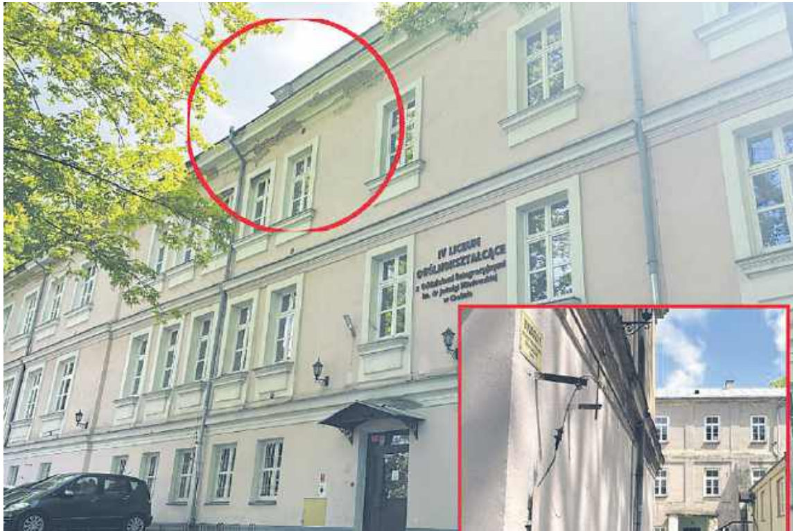
Ponad 100-letni budynek IV LO w Chełmie objęty jest ochroną konserwatorską, co zapewne podniesie koszt jego remontu, ale inwestycja jest nieodzowna - mury zaatakowała pleśń, z elewacji odpadają fragmenty tynku
