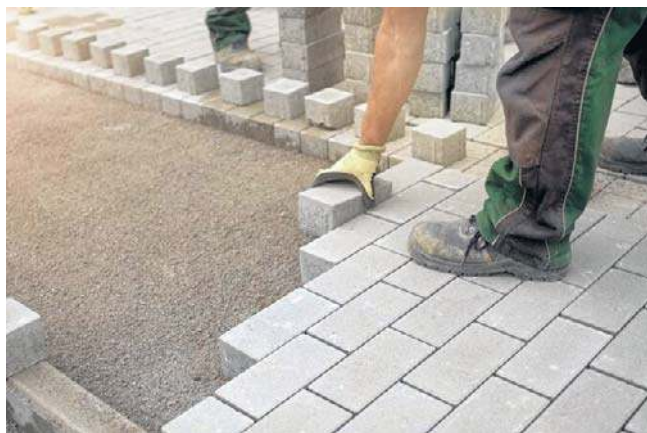
W trakcie budowy chodnika trzeba będzie ułożyć około 2300 metrów kwadratowych kostki brukowej
