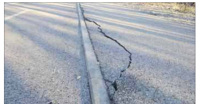
Pęknięcia na chodniku przy велоstradzie. Fot. Patrycja Koprzak
