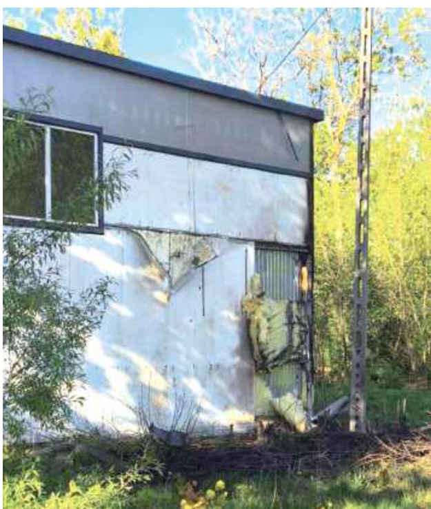
W wyniku intensywnego oddziaływania ciepłego zapaliła się częściowo ściana zewnętrzna. Hala wykonana jest w technologii płyty warstwowej
