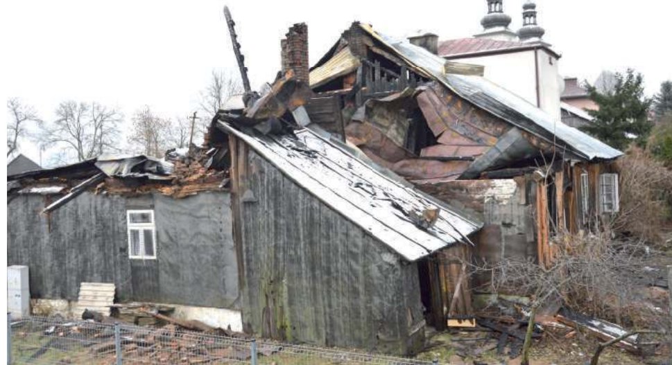
Spalił się dach, zawalił strop, wypaliło wyposażenie
