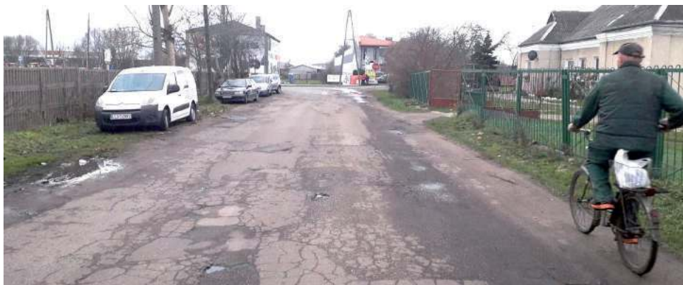
Ulica Objazdowa wymaga solidnego remontu
