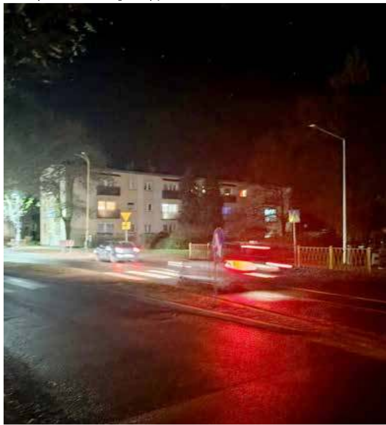
Na zdjęciu awaria w obrębie skrzyżowania z ul. 3 Maja. Nie działa nawet niedawno uruchomiony punkt oświetlenia przy przejściu dla pieszych
