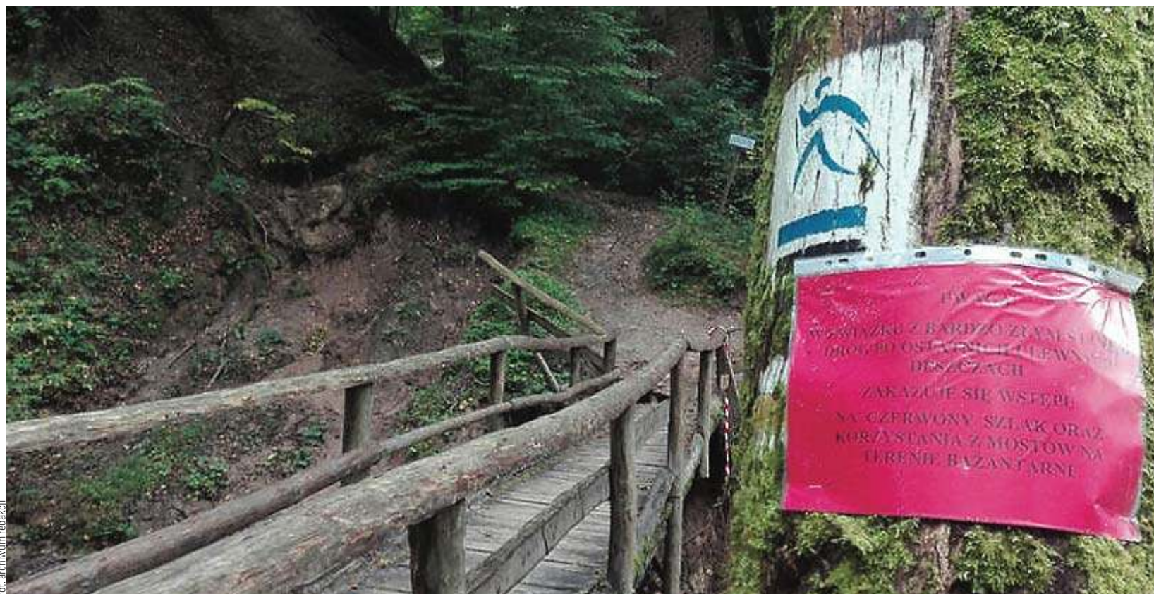
Mostek Elewów po powodzi w 2017 roku został wyłączony z użytkowania
