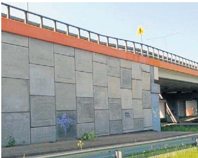
Stan muru oporowego wiaduktu w obwodnicy południowej Radomia zaniepokoił kierowców.
