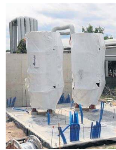
Nowa instalacja będzie wykorzystywać wyłącznie energię elektryczną
