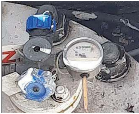
Na szczęście udało się zlikwidować wyciek.
