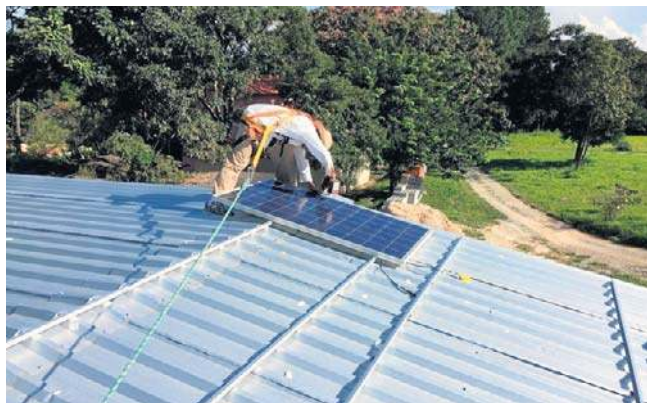
Instalacje o mocy do 5 MW, przeznaczone na własny użytek, nie będą już wymagały uzyskania koncesji
