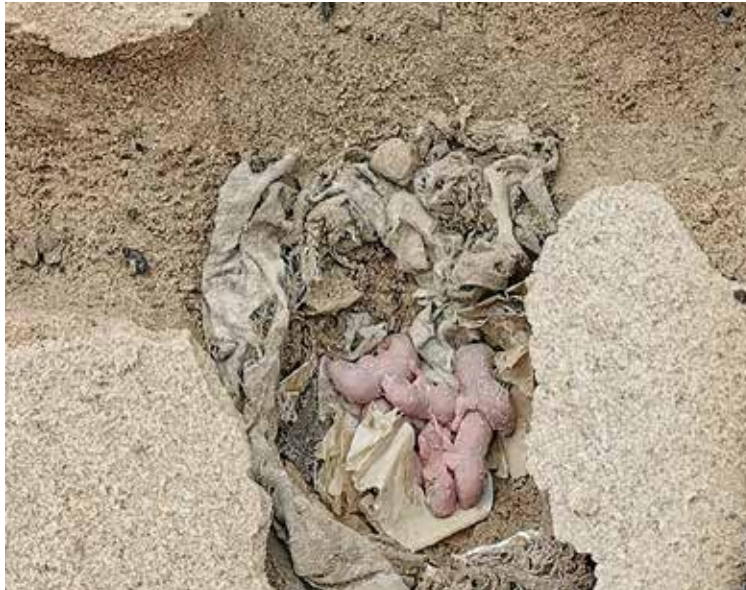
Gniazdo szczurów ujawnione w trakcie prac związanych z usuwaniem jednej z usterek
