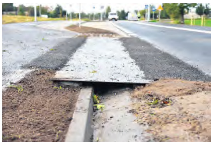
Mieszkańcy nie kryją oburzenia dla inwestycji, w której wjazdy wykonano za pomocą blach i drewnianych kantówek.
