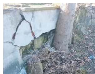
Ogrodzenie w niektórych miejscach grozi zawaleniem.
