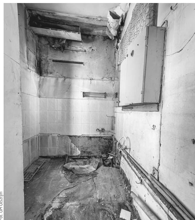
Tak wygląda jedno ze zniszczonych przez najemców mieszkań komunalnych
