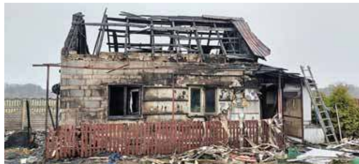
Straty spowodowane pożarem domu są bardzo duże
