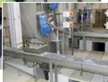
System selekcji odpadów w ściekach
