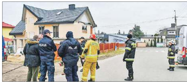
Uszkodzony podczas prac budowlanych gazociąg stworzył realne niebezpieczeństwo wybuchu, dlatego z okolicznych domów ewakuowano mieszkańców i zablokowano drogę
