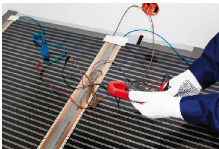
❗ Przed wykończeniem ogrzewanej podłogi trzeba się upewnić, czy instalacja działa prawidłowo. ZAMEL
