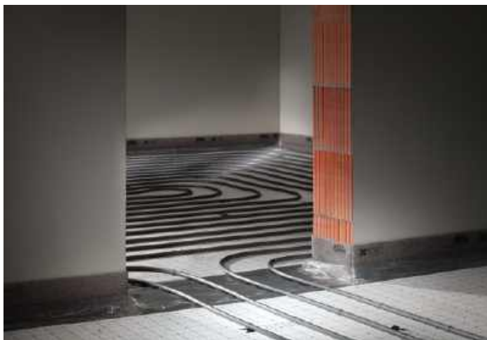
🔧 Wodne ogrzewanie wymaga odpowiedniej konstrukcji podłogi, dlatego projekt systemu musi być dobrze przemyślany. KERMI
