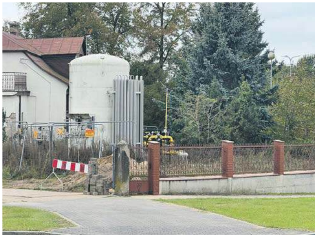
Tymczasowa stacja gazu, zasilić sieć wybudowaną w Przytyku.
