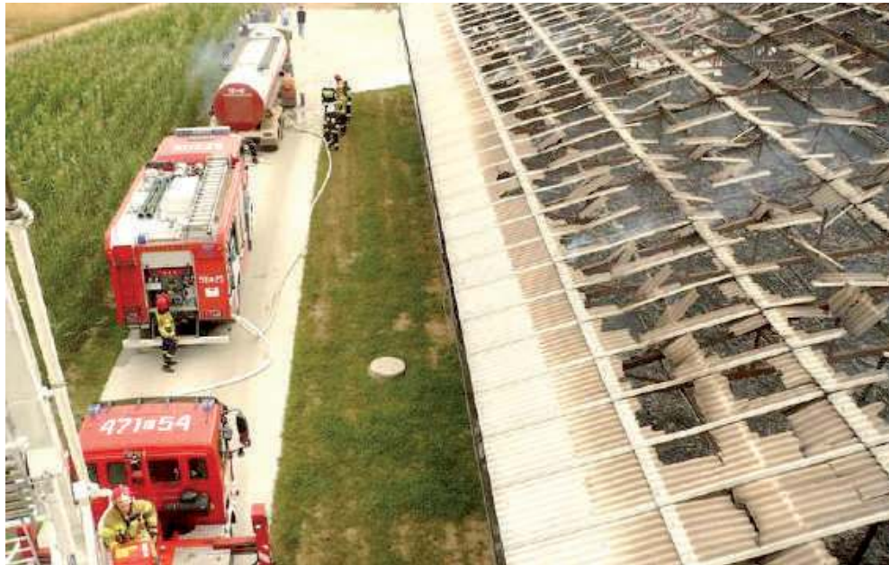
Do akcji w Zofiborze wyjechało 19 zastępów straży pożarnej. Część pozostała w gotowości bojowej
