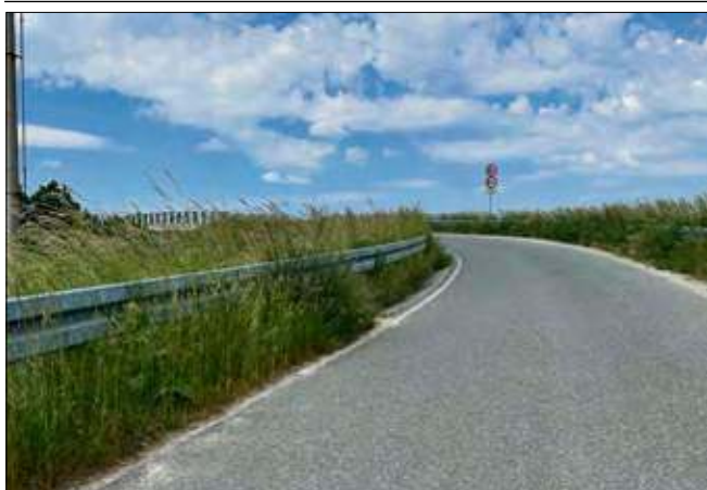
Wysoka trawa ogranicza widoczność na wiadukcie między Malnią a Odrowążem.
