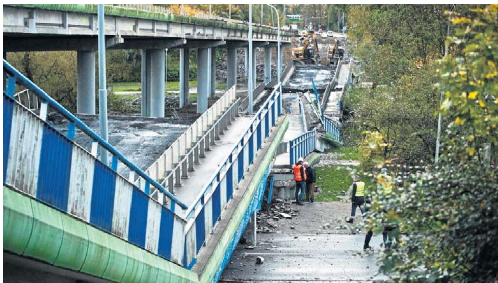
Do niekontrolowanego zawalenia się jednej nitki wiaduktu doszło podczas prac rozbiórkowych 21 października 2021 r.
