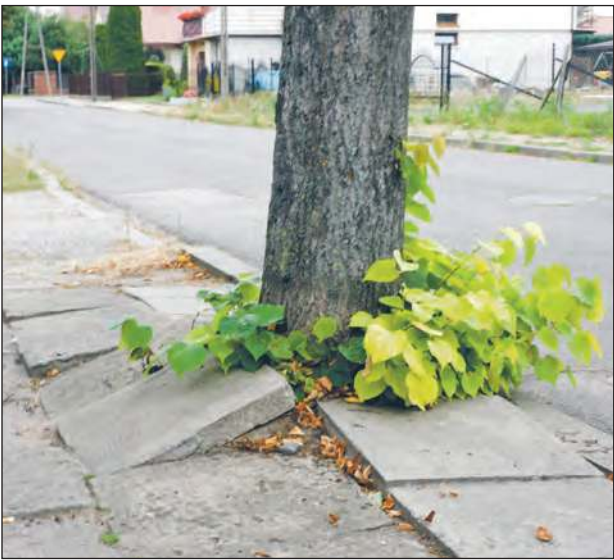
Stare, kilkudziesięcioletnie drzewa, rozrastając się, wypchnęły korzeniami płytki chodnikowe, które teraz stwarzają niebezpieczeństwo dla mieszkańców
