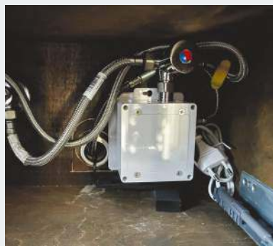
● W szafce, pod taką baterią, ulokowano m.in. mieszacz, sterownik temperatury i zasilacz z bateriami typu paluszki.
