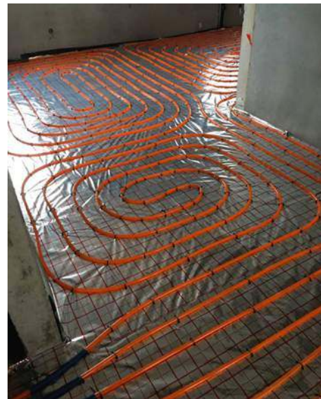
📍 Pompa ciepła najlepiej sprawdza się we współpracy z niskotemperaturowym ogrzewaniem płaszczynowym, u nas jest to najczęściej podłógówka. rwc
