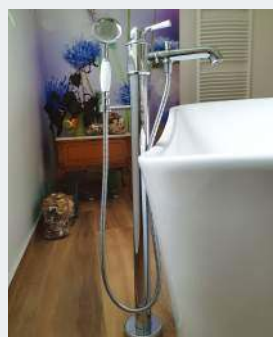
🔑 Przy wannie zamontowano w posadzce baterię stojącą o wysokości 94 cm.
