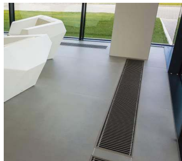
Grzejniki kanałowe najczęściej montuje się w pomieszczeniach, w których ściany zewnętrzne są przeszklone. VERANO
