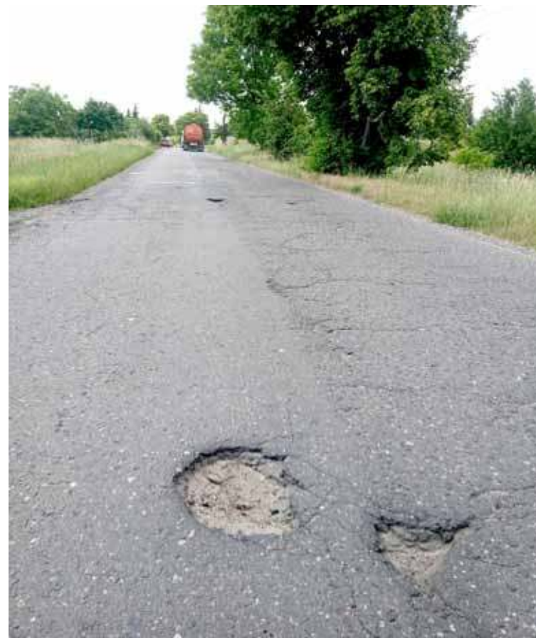
Mieszkańcy wskazują na powstałe dziury w nawierzchni ulicy Morskiej.
