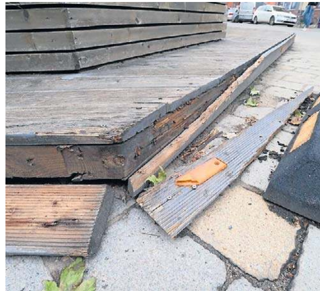
Drewniane konstrukcje się sypią. Dosłownie
