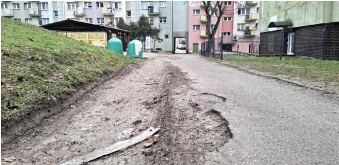
Fragment drogi przy ul. Płatnerzy nadaje się do natychmiastowego remontu
