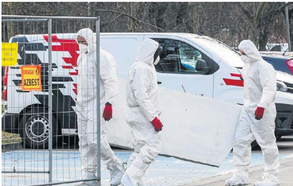
Mieszkaniec twierdzi, że worki z azbestem są składowane obok bloku nr 22, a wywiezione zostaną dopiero po zakończeniu pracy w trzech budynkach
