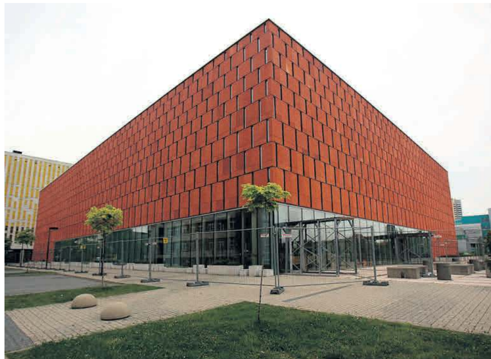
Bryła prosta, elewacja nieoczywista i piękna. Pozostaje - niestety - problem odpadających elementów, z czym konstruktorzy budynku próbują się od lat uporać. To kłopot
