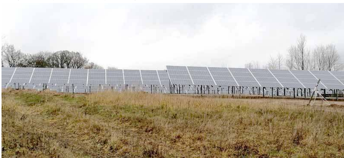
Dwie instalacje fotowoltaiczne, o mocy 250 kW każda oddano w Bobrownikach
