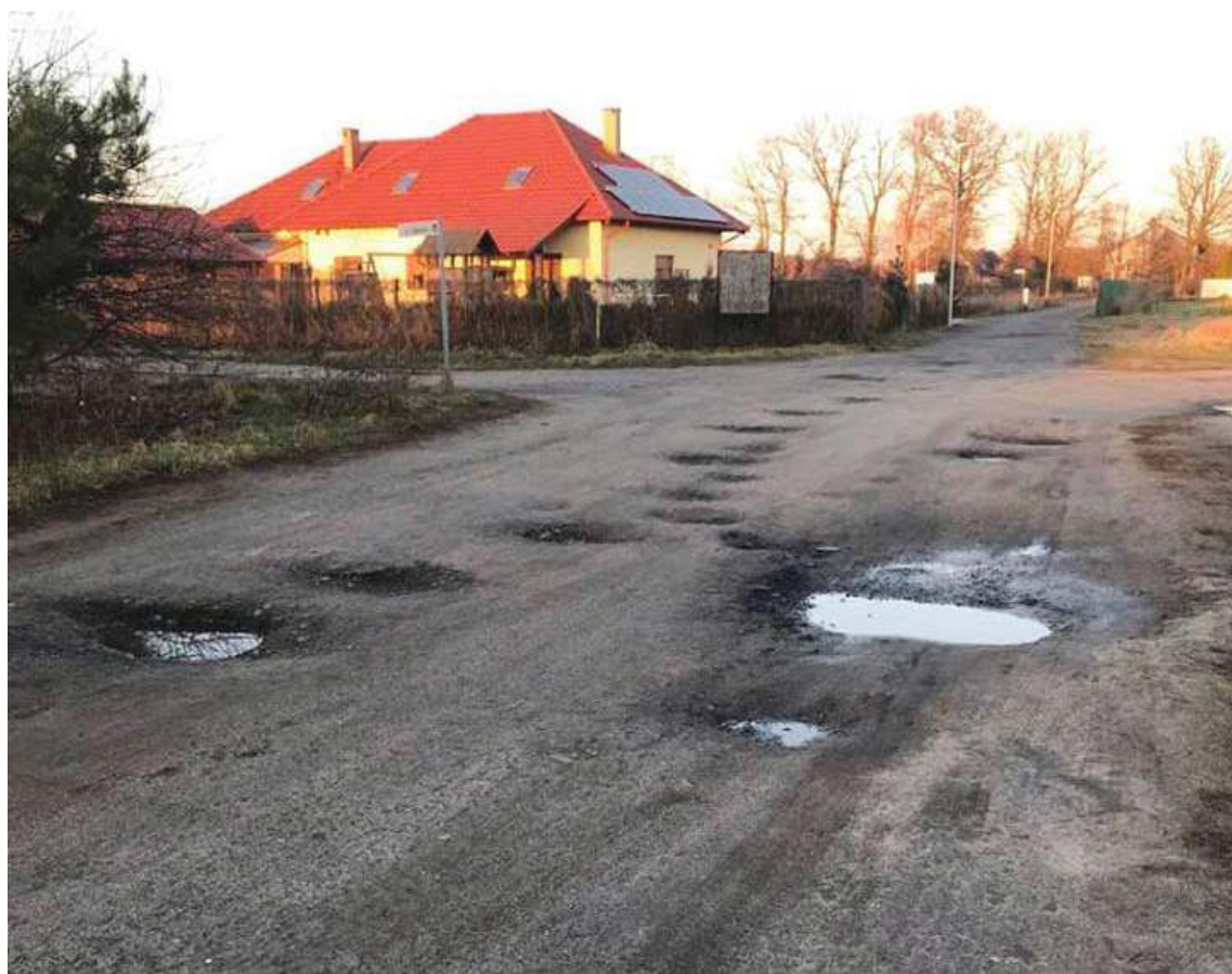
Dziur w ulicy Bukowej ciągle przybywa i już nie da się ich wyminąć
