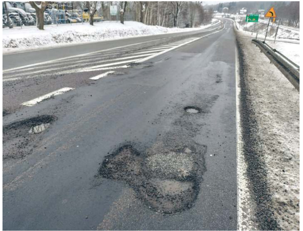
Dziury na DK17 na odcinku Krasnystaw – Izbica
