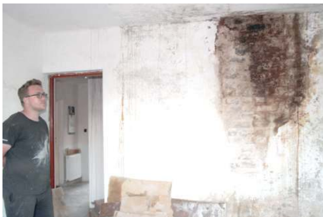
Nie wiadomo, czy nie będzie trzeba zrywać tynków w pokojach. Zniszczenia są ogromne.
