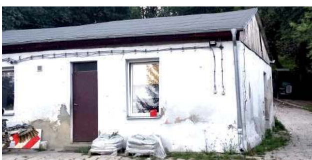
Obecny stan budynków gospodarki komunalnej jest opłakany. Na przełomie sierpnia i września rozpocznie się budowa nowej siedziby, która przeniesiona zostanie a obrzeża Nałęczowa
