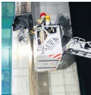
Pożar elewacji Narodowego Banku Polskiego
