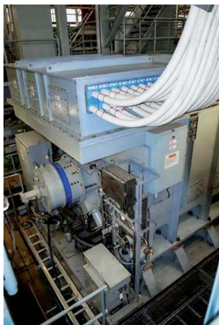
▲ Silnik elektryczny napędu okrętowego dużej mocy wraz z układem zasilania i chłodzenia.
