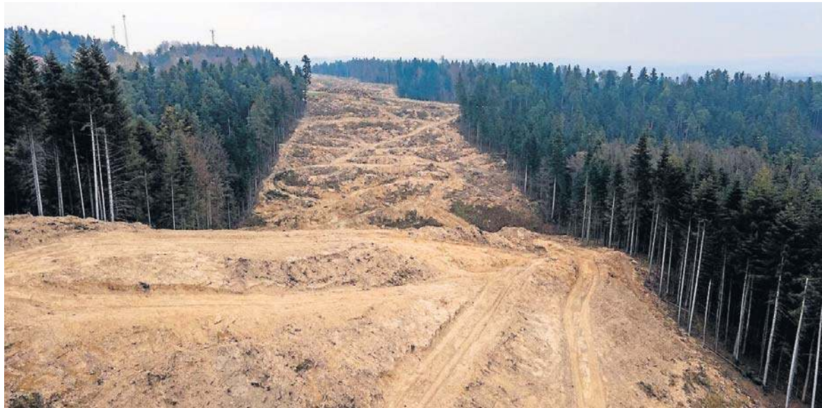
Wrzesień 2026: smutny obrazek. Opuuszczony przez Mostostal odcinek S19 Domaradz - Iskrzynia, którym mieliśmy jeździć już w 2025 roku
