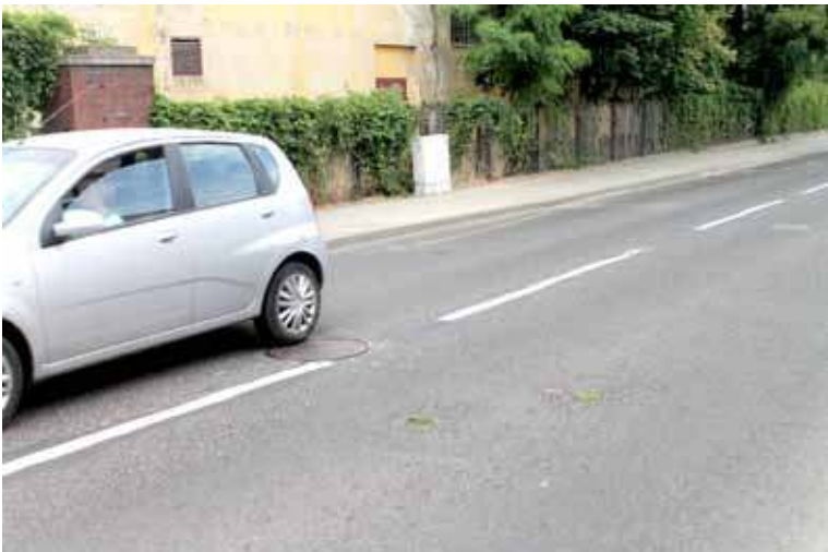
Na Kochanowskiego odstają od nawierzchni pokrywy studzienek, co powoduje konieczność ich wymijania
