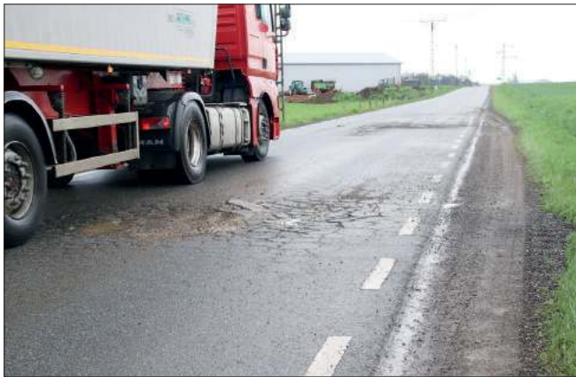
Droga powiatowa relacji Modzurów – Pawłów obecnie przypomina tor z przeszkodami. Umiejętne ominięcie dziur gwarantuje ratunek m.in. dla zawieszona naszego samochodu. Wydaje się jednak, że nie tak ta trasa powinna wyglądać...
