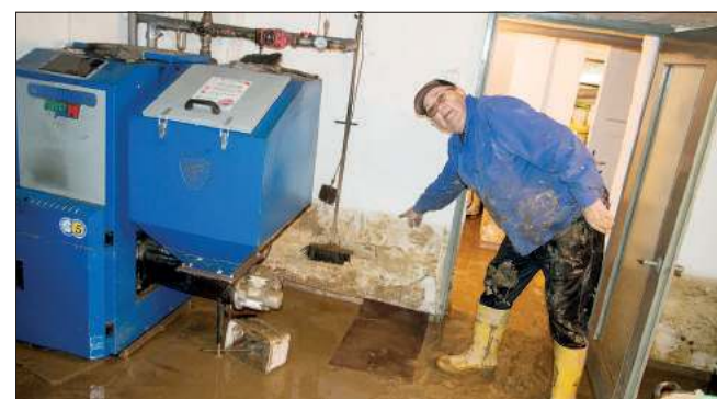
Józef Irzik pokazuje, dokąd sięgała woda w kotłowni jego domu. Nowy piec nie nadaje się do użytku. Zamócił również opał. – Wszystkiemu winne są zasiewy do skraju pola, bez pozostawienia pasa zieleni – twierdzi mieszkaniec wsi
