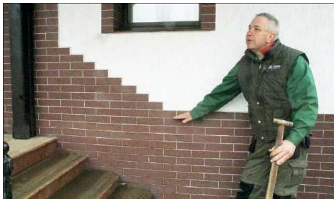
Pan Paweł z restauracji „Staruszek” wskazuje miejsce, do którego dotarła woda
