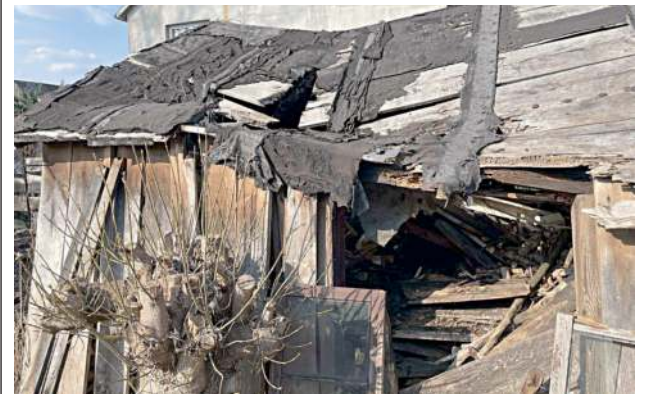
Spaliło się: drewniany płot o długości 10 metrów, krzewy ozdobne oraz nadpalone zostały ściany budynku, w którym przechowywano drewno opałowe
