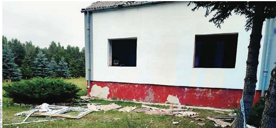
Wybuch gazu uszkodził budynek
