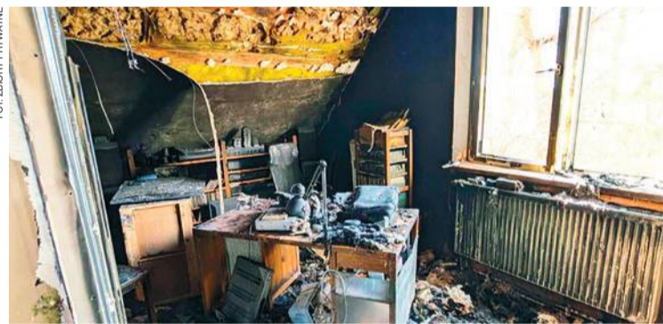
Pożar zniszczył poddasze domu, strop i dach. Samotnemu ojcu z córką potrzebna jest pomoc
