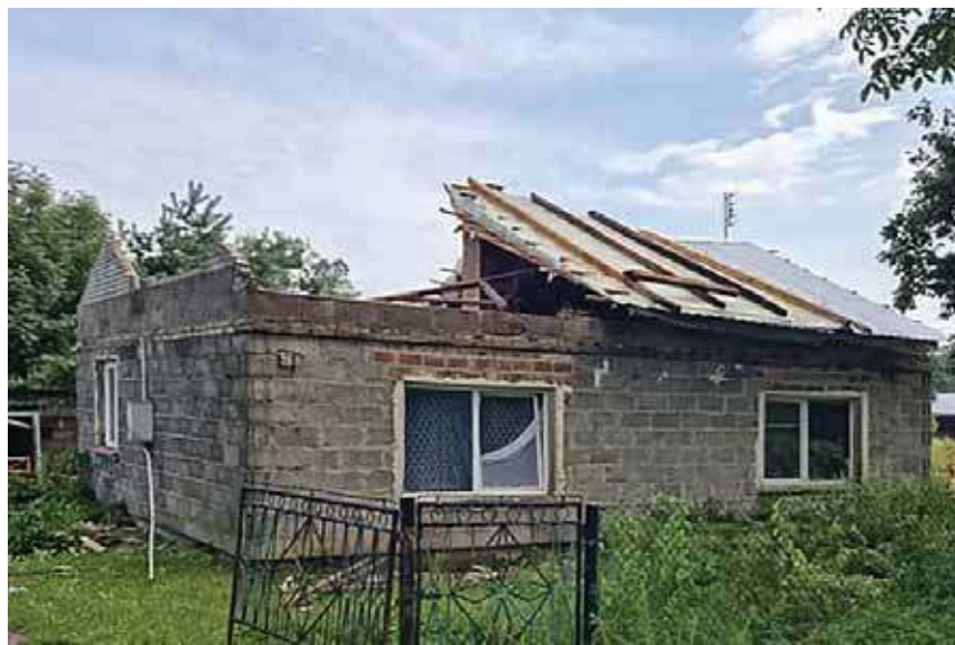
Uszkodzony dom strażaka ochotnika
