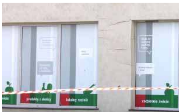
Na ścianie budynku widać bardzo duże pęknięcia
