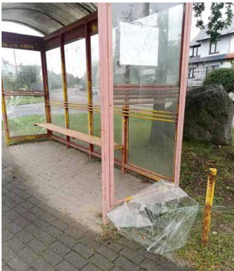
Takie skutki wandalizmu widać na przystanku w Kłębiniu
